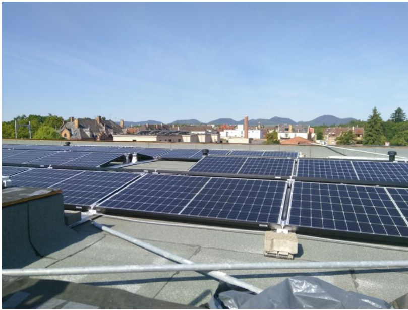
Abbildung 4: Die fertige Anlage auf dem Dach der GeWoLD Landau
